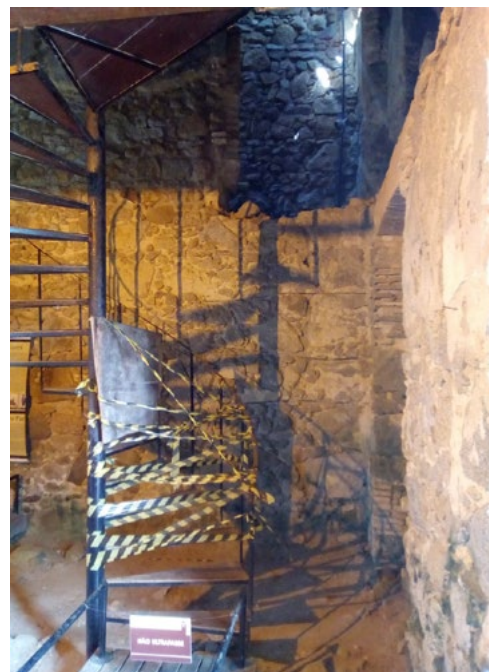
Figura 5 – Detalhe do interior da Casa do Comandante da Fortaleza de São José da Ponta Grossa, onde é possível observar diferentes materiais utilizados para o restauro
